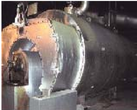
ボイラー の保温材
